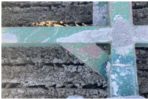
③多少の腐食、歪みあり
