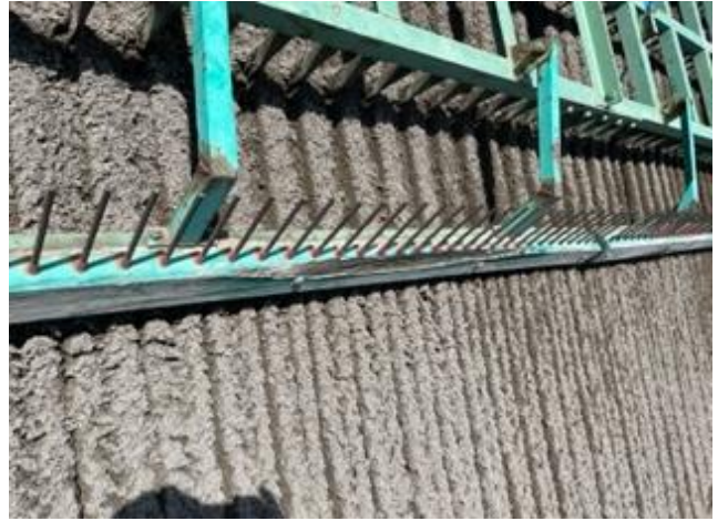
④均し爪打ち込み部の木材は、ひび割れ腐食 多数
