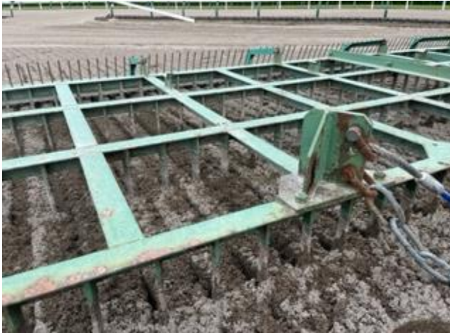
⑤ 多少の腐食、歪みあり
