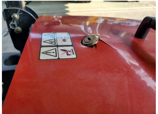
④エンジンカバー破損部(鍵にて開閉可能)
