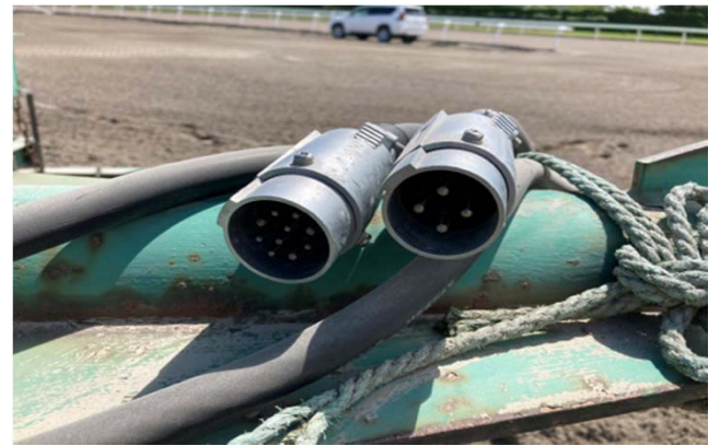
油圧稼働用電源ソケット部(右側)、油圧操作盤ソケット(左側)
