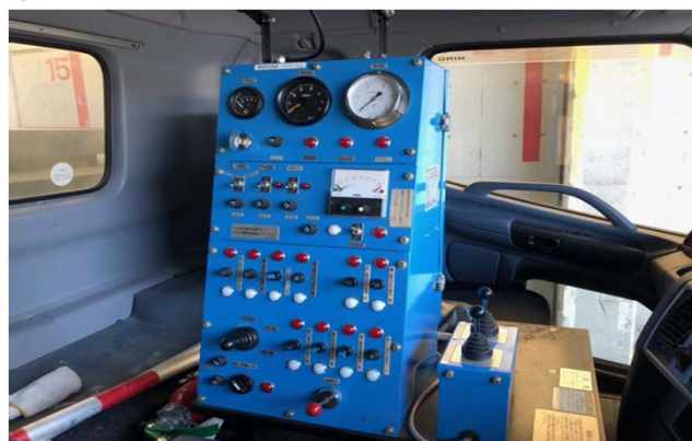
⑧サブエンジン操作盤
