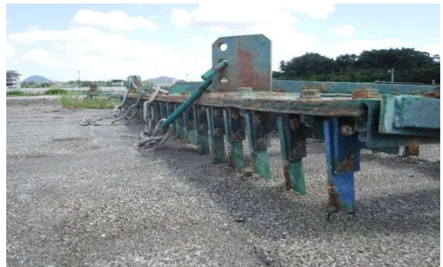
○フレーム前方 平爪取付部歪み有り
